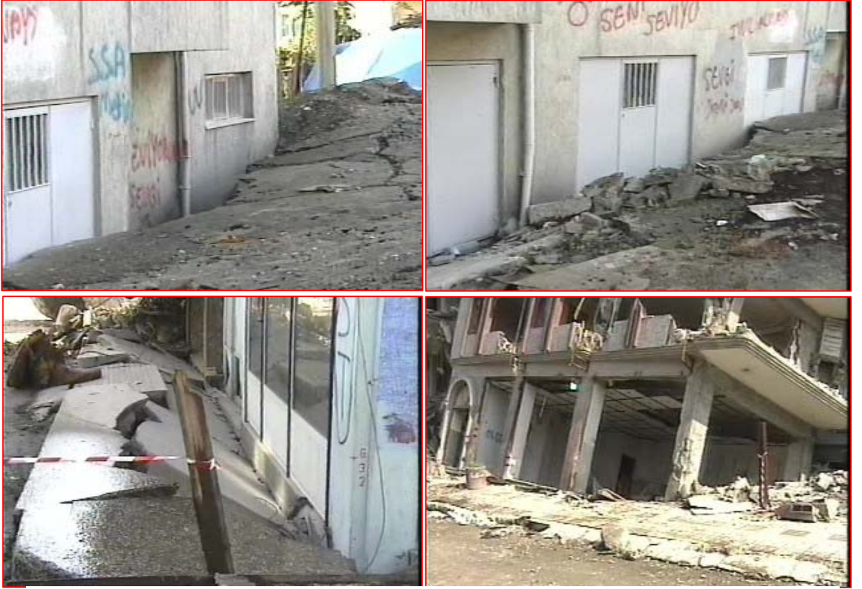
Şekil 7. Yapı hasarları (Adapazarı)
