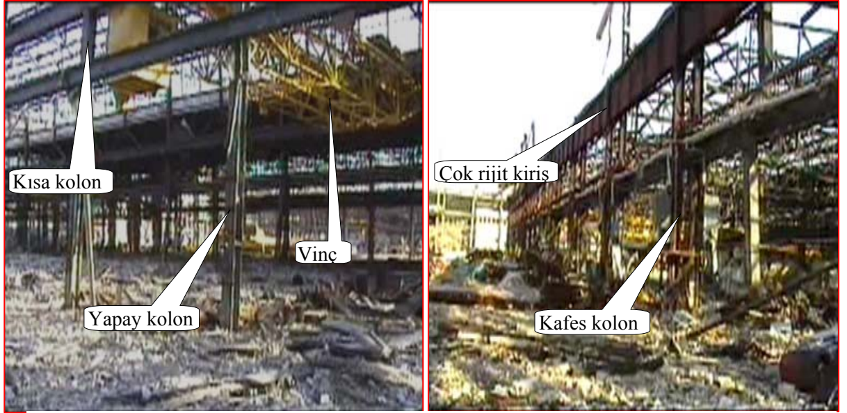
Şekil 8. Çelik yapı hasarlarından bir kaç
