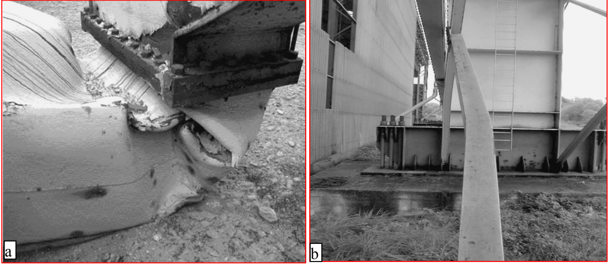
Şekil 6. Çelik yapı hasarlarından bir kaç
