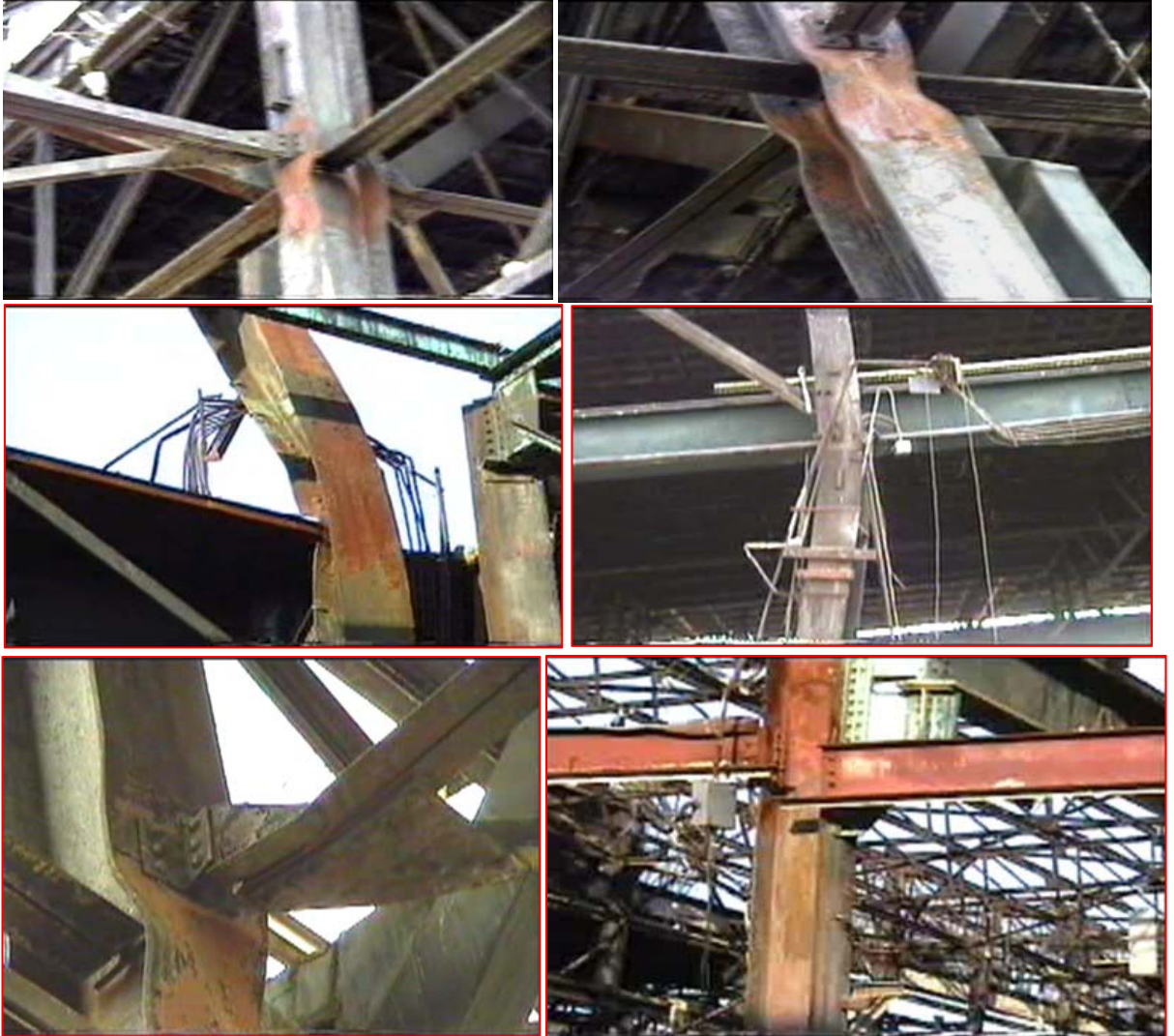
Şekil 11. Düğüm noktası hasarları
