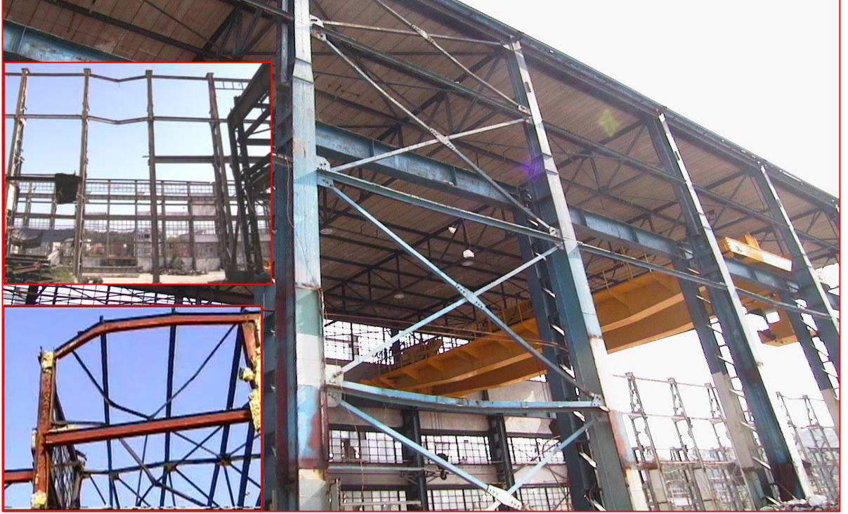
Şekil 13. Rüzgar bağlantıları hasarları
