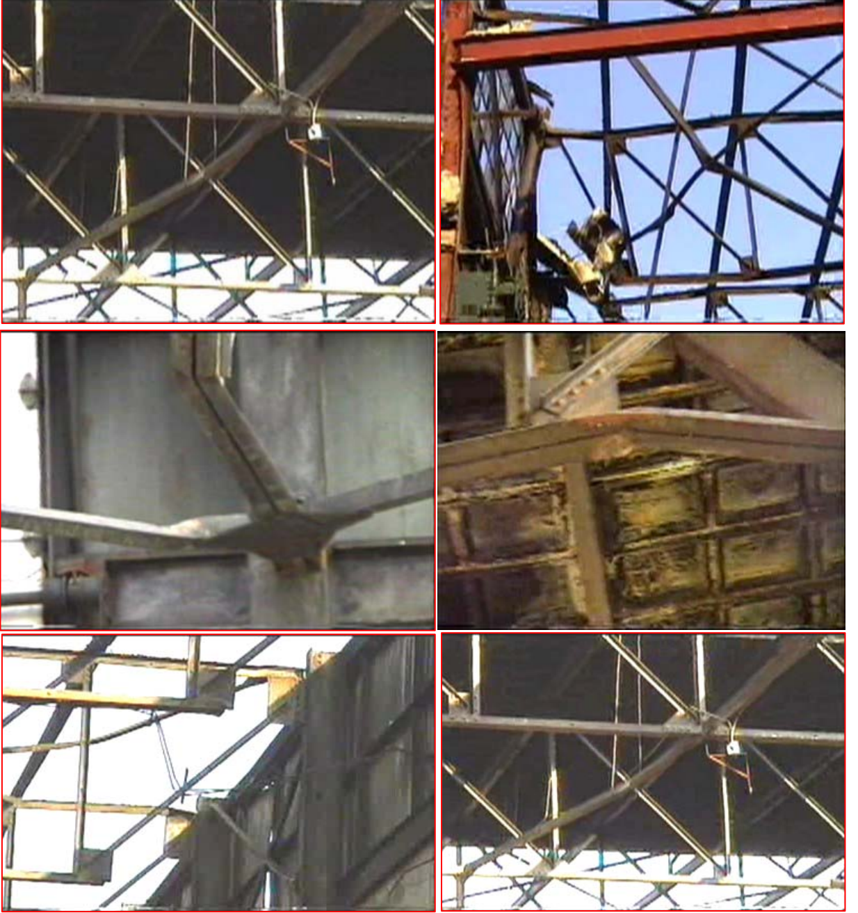
Şekil 12. Kafes kiriş hasarları
