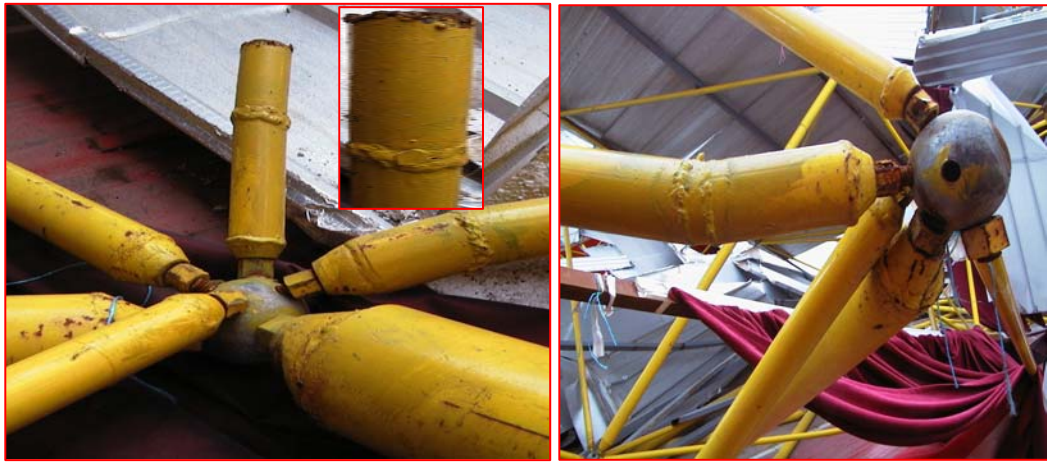
Şekil 9. Kılıçoğlu Anadolu Lisesi uzay kafes sistem hasarları [4]
