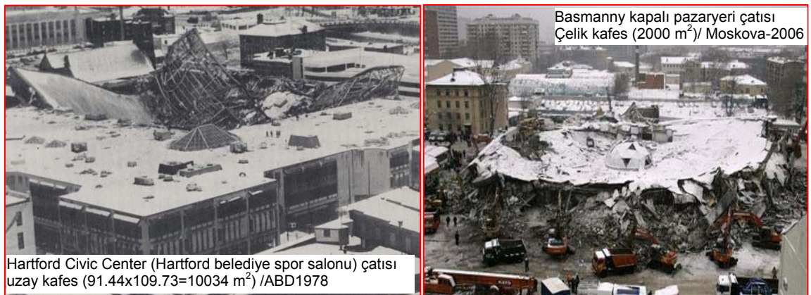
Şekil 12. Kar yükünden dolayı hasar gören uzay ve kafes yapıları [4]
