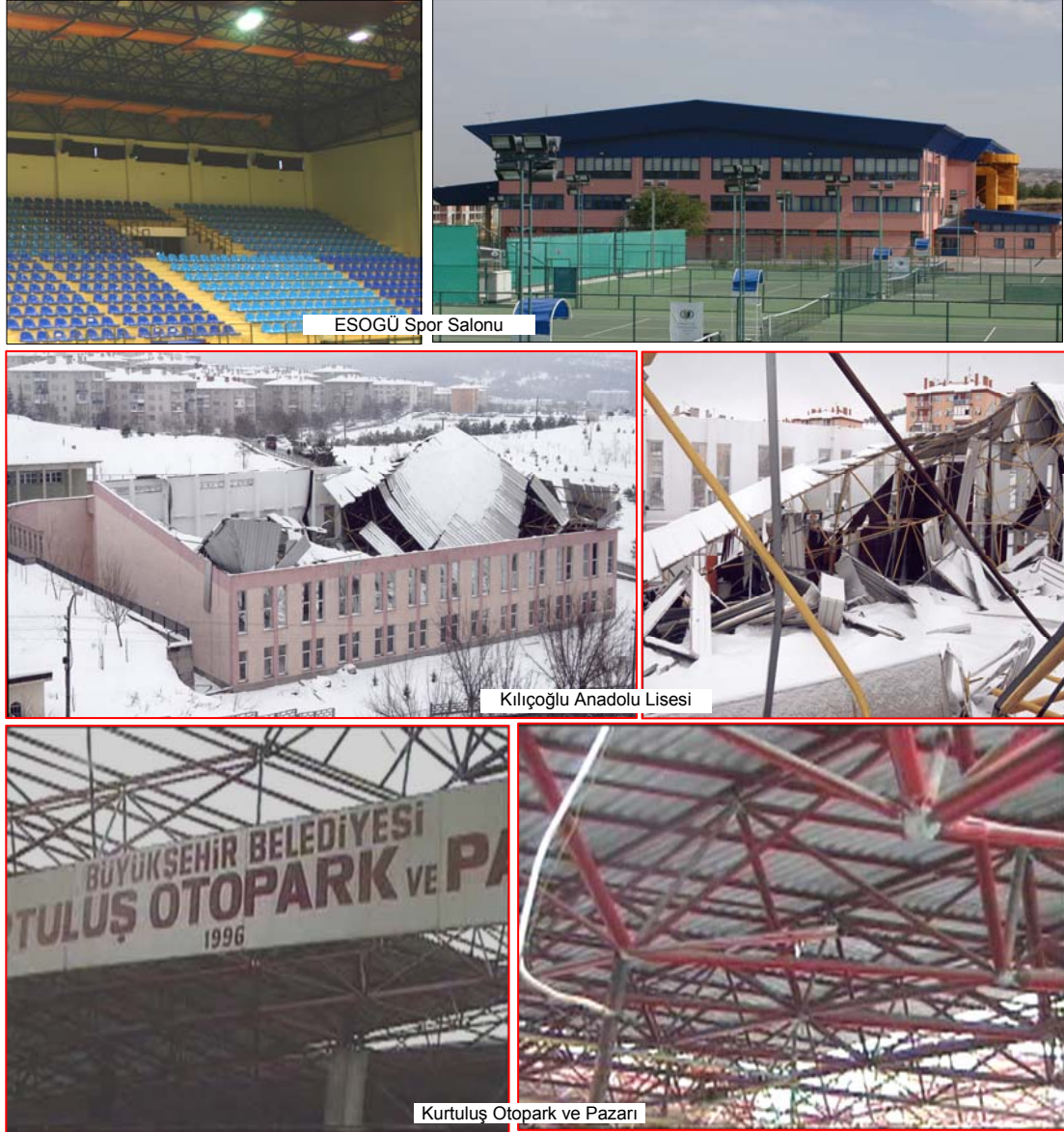
Şekil 4. Eskişehir’de hasar gören uzay kafes sistem yapıları
