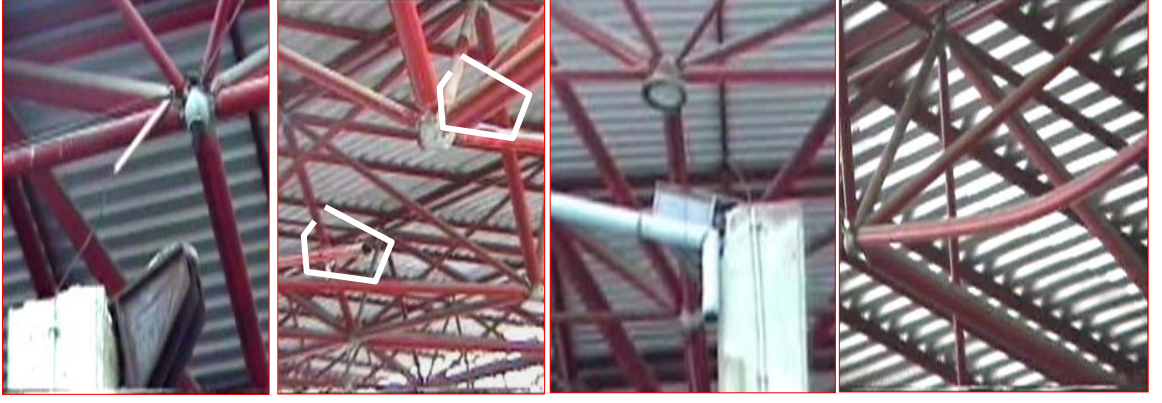
Şekil 10. Kurtuluş pazarı uzay kafes sistem hasarları
