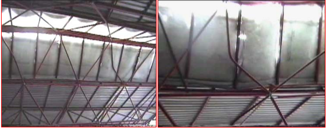
Şekil 6. Kurtuluş pazarı hasarı
