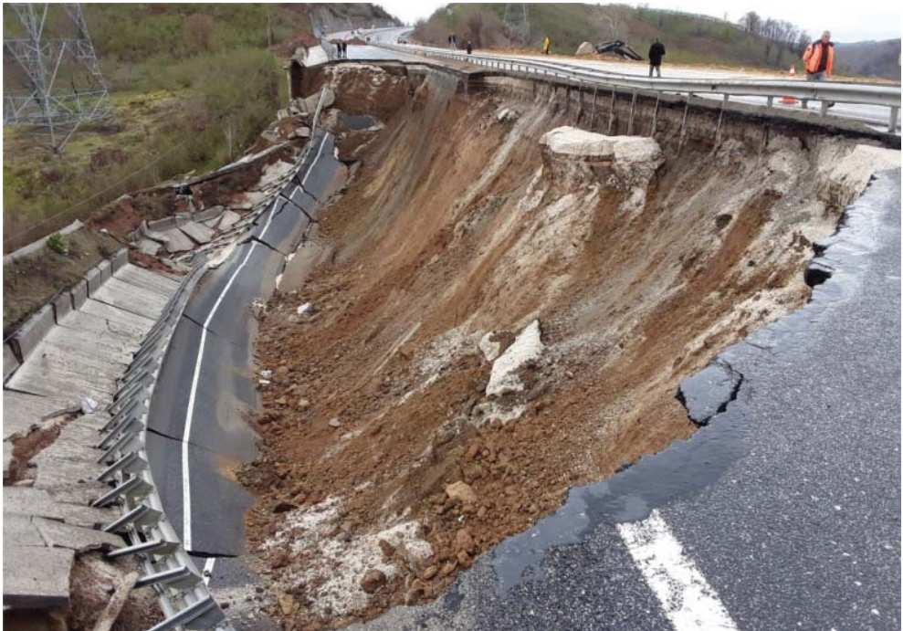
Şekil 11b - Göçme bölgesi genel görünümü
