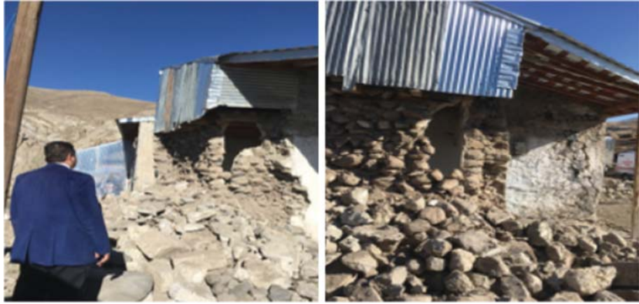
Şekil 11 - Bağlayıcı derzlerin bırakılmamasından dolayı oluşan kesme hasarları
