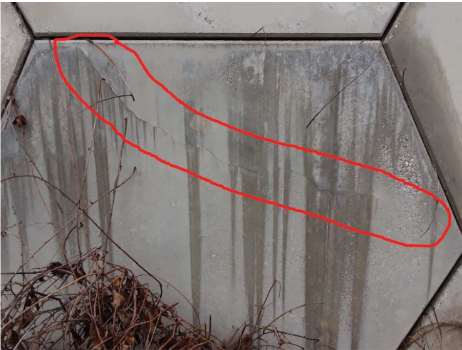
Şekil 10 - Prekast cephe elemanında görülen çapraz çatlak
