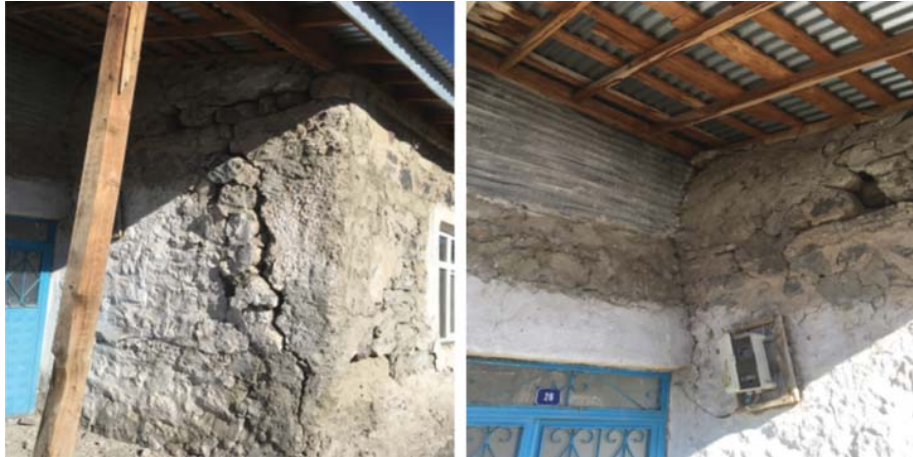
Şekil 12 - Çatı ile yığma duvar bağlantısı hasarları
