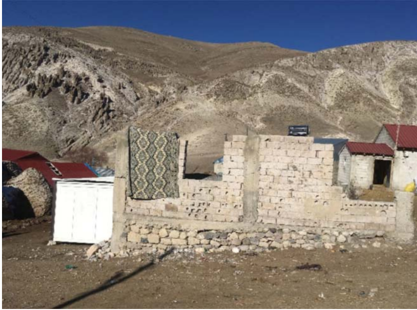
Şekil 16 - Hasar almamış yığma duvar
