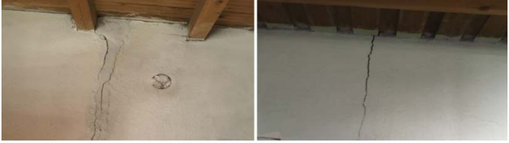
Şekil 15 - Duvarlarda gözlemlenen hasarlar
