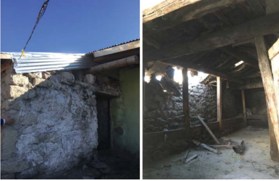
Şekil 13 - Çatı ve döşeme bağlantısı hasarları
