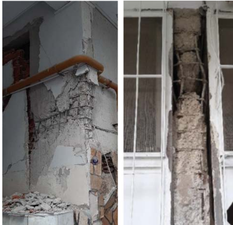
Şekil 14 - Kolon ve perdelerde gelişen hasarlar
