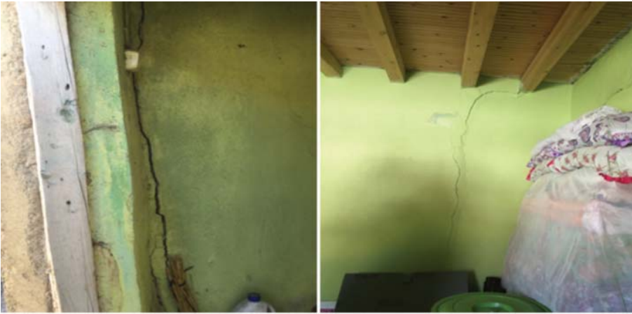
Şekil 14 - Duvar bağlantısı hasarları
