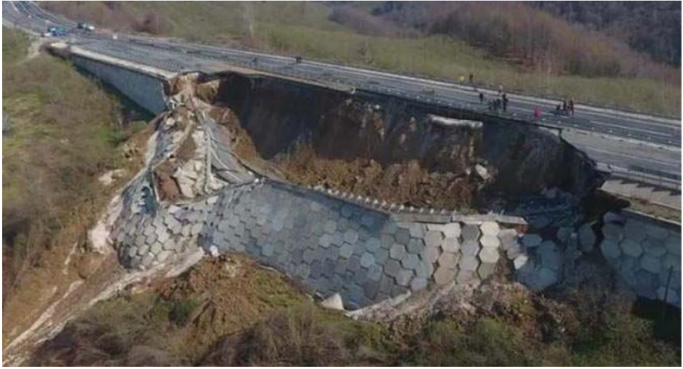
Şekil 11a - Göçme bölgesi genel görünümü
