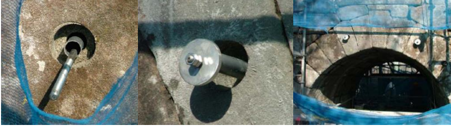
Şekil 15. Paslanmaz çelik çubuklar ile ankraj uygulaması Oliveira ve Lourenço, (2004)
