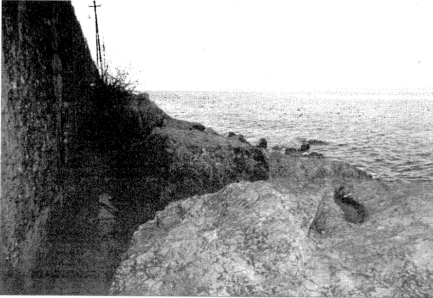
Fotoğraf 2 Dalgakıranda oluşan çökme nedeniyle mevcut durumdan bir görünüş.
