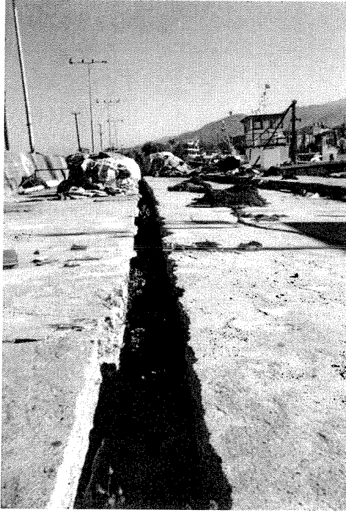
Fotoğraf 1 Dalgakıranda oluşan hasar görüntüsü
