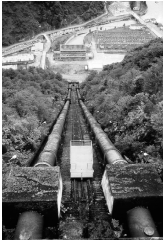
Şekil 10 – Harşit havzasında, 183 m düşülü, cebri boru çapları 1,85 m olan Doğankent A santrali (Foto: Ü.Öziş).
