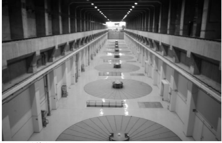
Şekil 3 - Atatürk barajı etek santralinde jeneratör holünün görünüşü (Foto: Ü.Öziş).
