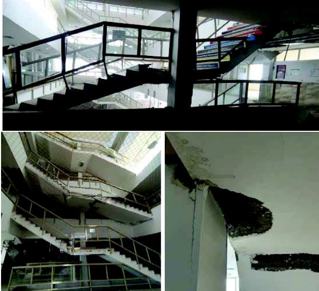
Şekil 2. Görelî kat ötelenmesine uyumsuz rijit merdiven bağlantılarına bağlı hasara dair görseller.
