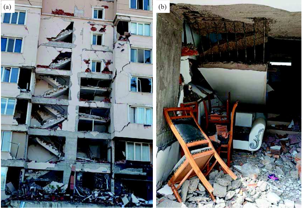
Şekil 3. (a) Görelî kat ötelenmesine uyumsuz rijit merdiven bağlantılarına; (b) Donatı detaylandırma ve işçilik kusurlarına bağlı hasara dair görseller.
