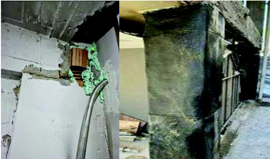
Şekil 1. Deprem sonrası sahada gözlenen tipik uygulama hataları
