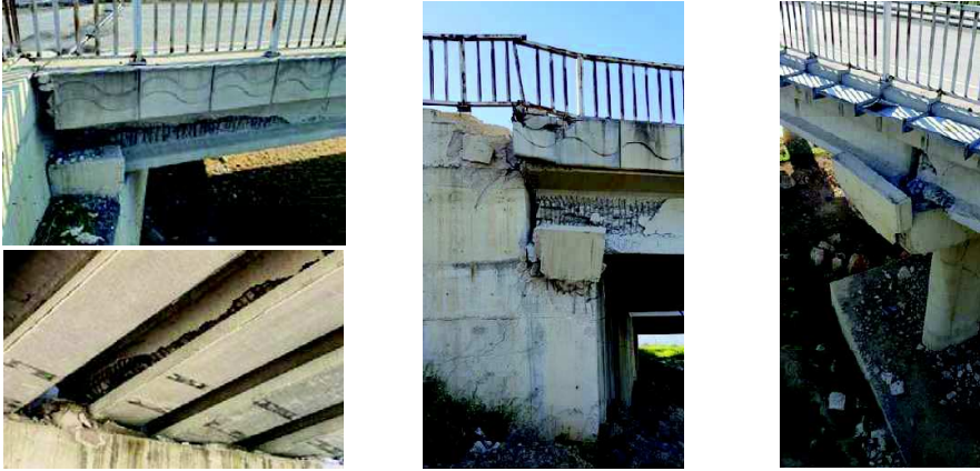
Şekil 2. 2023 Kahramanmaraş depremlerinde önüretimli köprü kirişlerinde meydana gelen düzlem dışı kesme hasarı örnekleri (Avşar vd., 2023)
