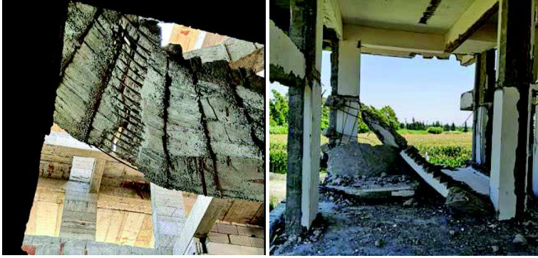
Şekil 1. Depremler sonrası betonarme merdivenlerde gözlenen tipik göçme/işlev kaybı örnekleri.
