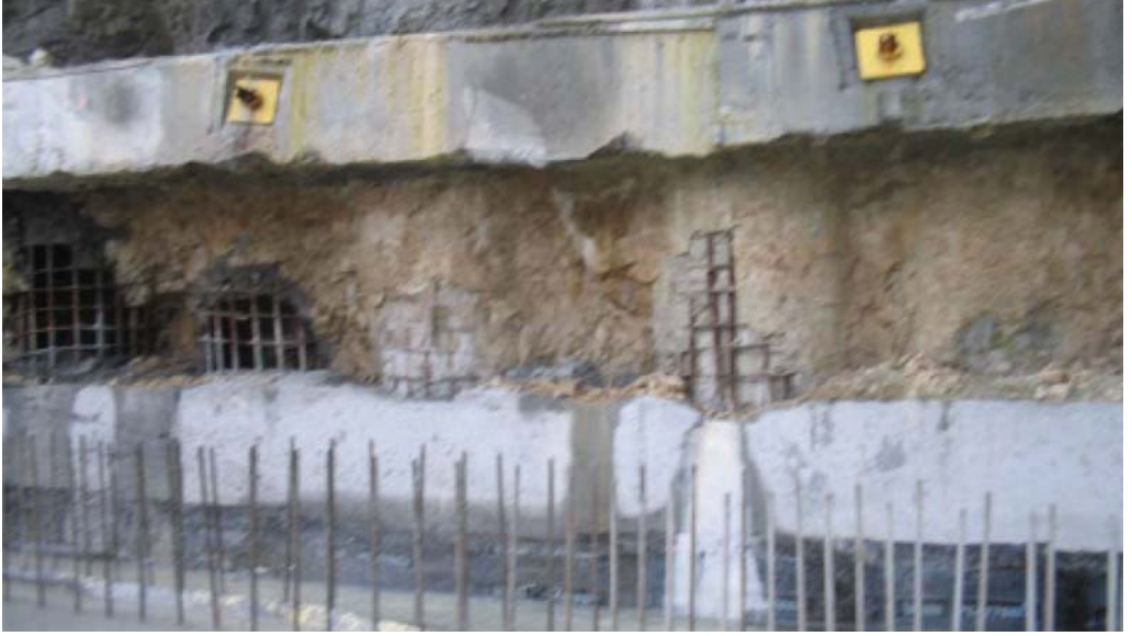
Şekil 8 - Gövde betonunda büyük boşluk (tam süreksizlik) bulunan kazıklar
