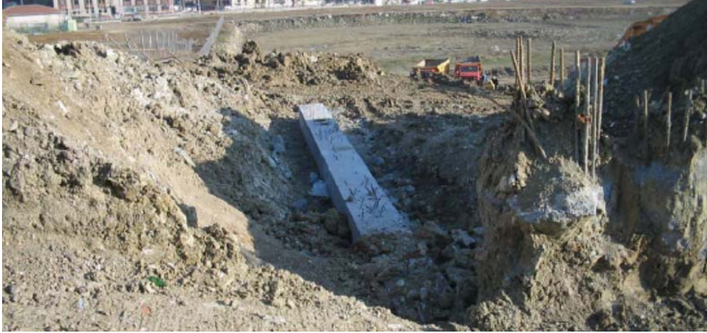
Şekil 14 - İksa arkasındaki aşırı sürşarj yüklemesi
